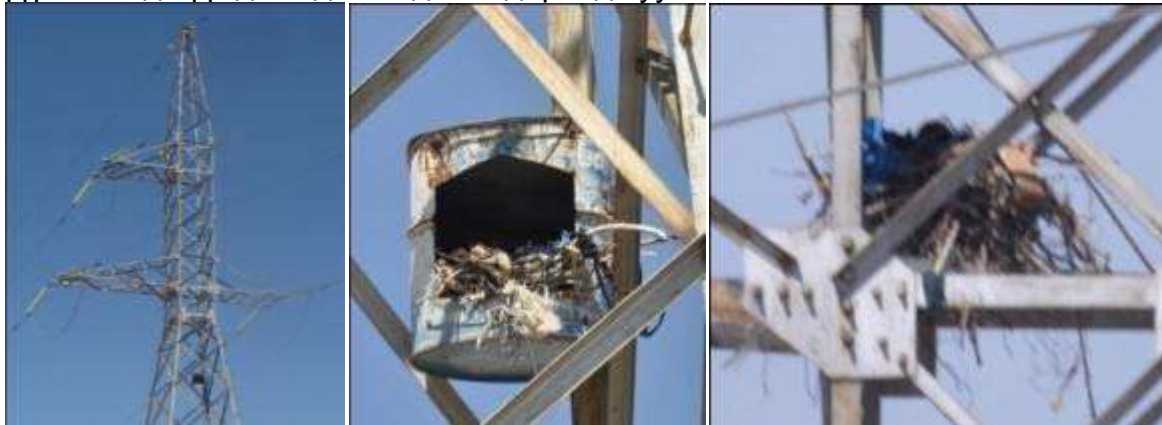
Зураг 44. Өндөр хүчдэлдээрх хиймэл үүр
