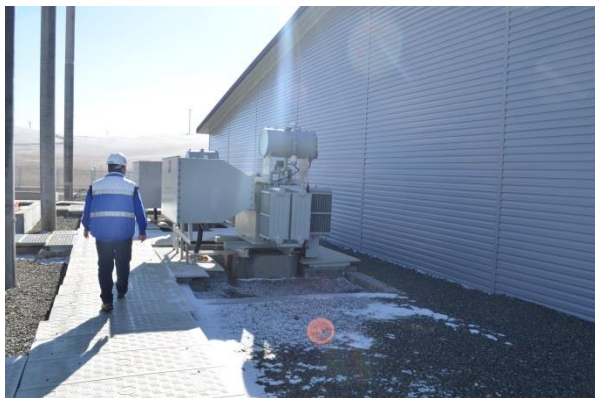
1.10-р зураг. 35/0.4 кВ-ын дотоод хэрэгцээний трансформатор
