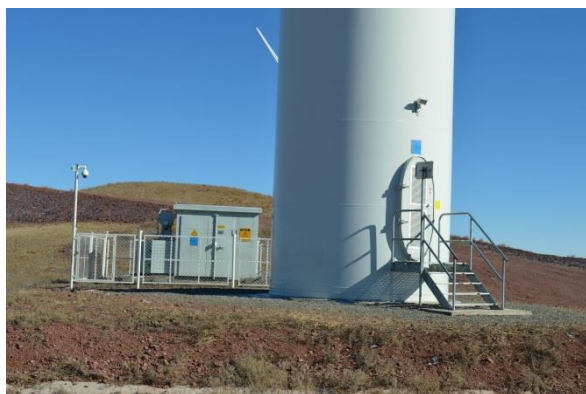
1.5-р зураг. Цамхагийн гаднах 35/0.69 кВ-ын өсгөх трансформатор
